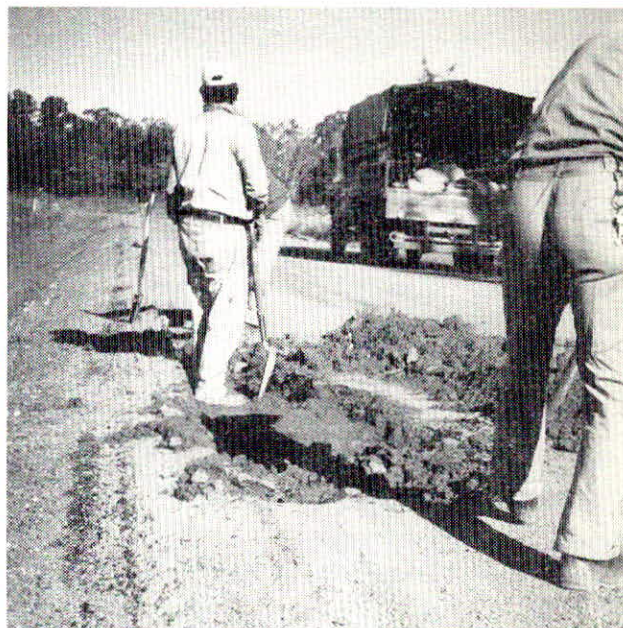
Barrio Urquiza: Saneamiento de baches sobre la banquina.
